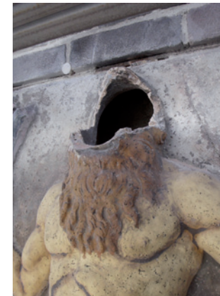
Defektes Keramik-Medaillon der Fassade
